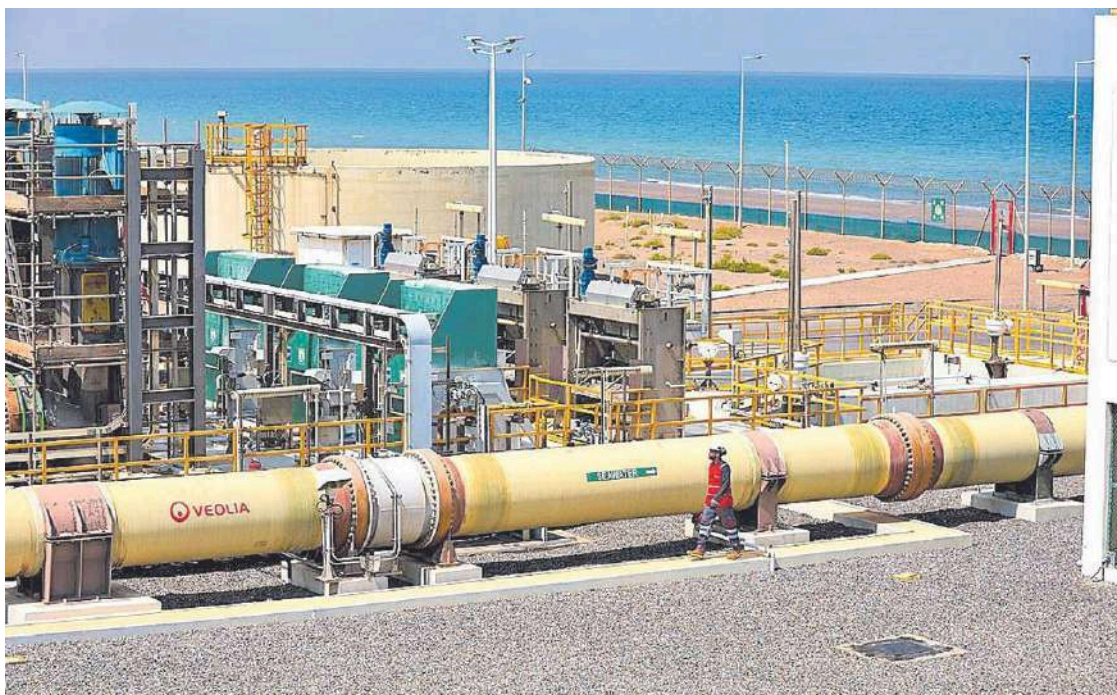
Vista general de una desalinizadora de Veolia. / EP
